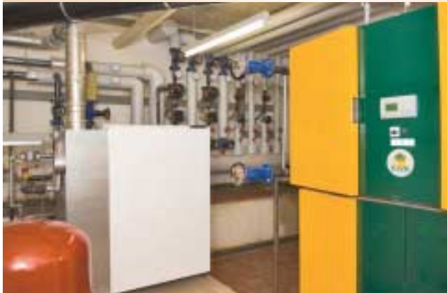
Eine Holzpelletanlage im Stadtwerke-Contracting heizt sauber und wirtschaftlich.
